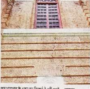
एफआरआइ के भवन पर दिखाई दे रही दरारें • जवाहर
